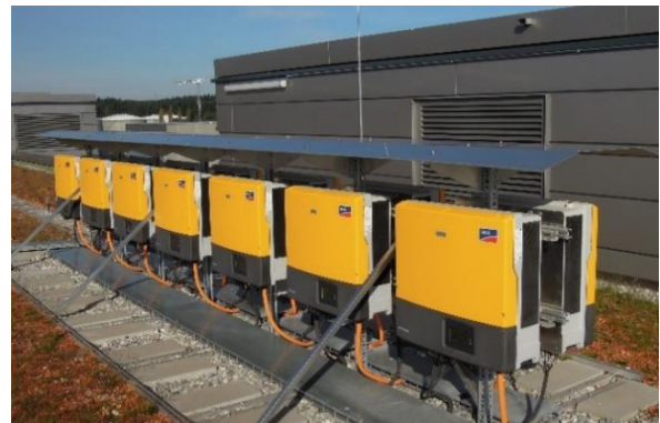
Anlage Pistor: String-Wechselrichter mit 17 kW Leistung
