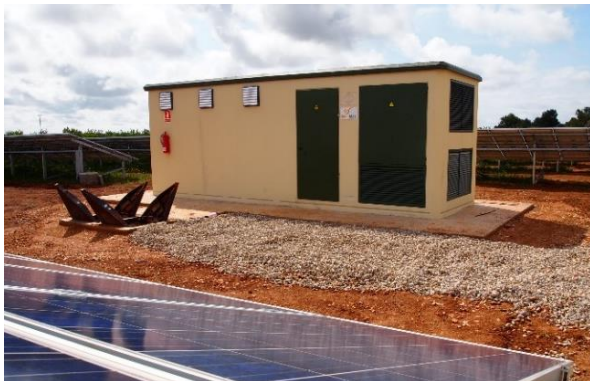
Anlage Cortadeta: Wechselrichter Gebäude mit drei 330 kW Zentral-Wechselrichtern
